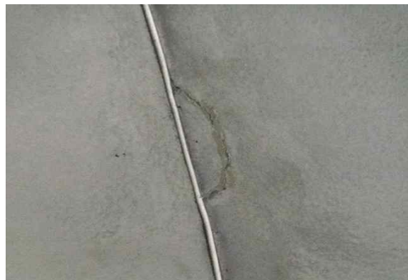
라이닝 SPAN.41 이음부 균열
