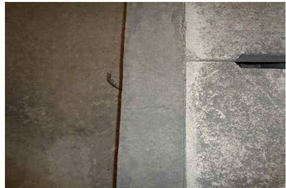
공동구 SPAN.36 균열(0.3mm 이상)
