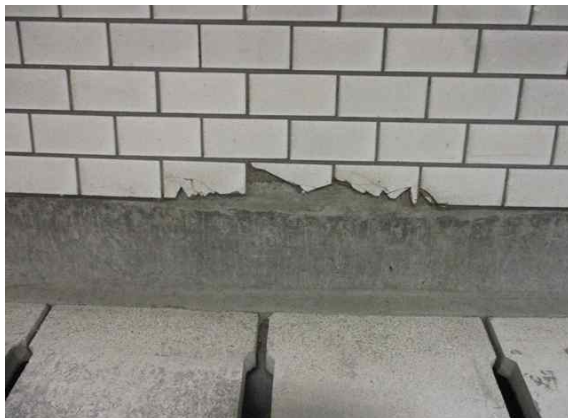
측벽부 SPAN.14 타일 파손
