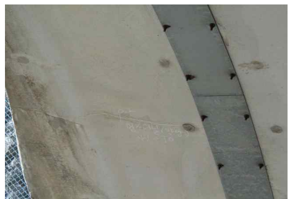
라이닝 SPAN.0 균열(0.3mm미만)
