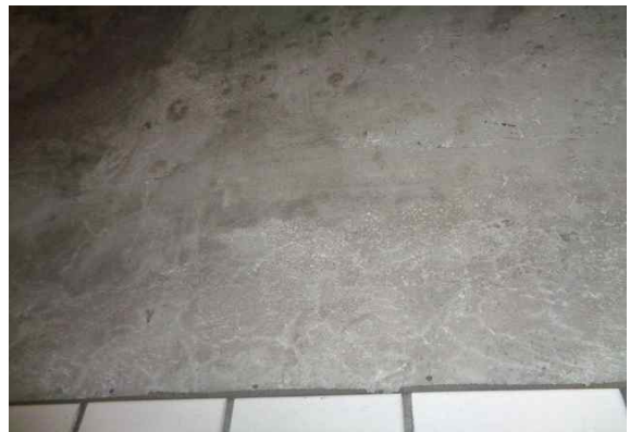
라이닝 SPAN.35 망상균열
