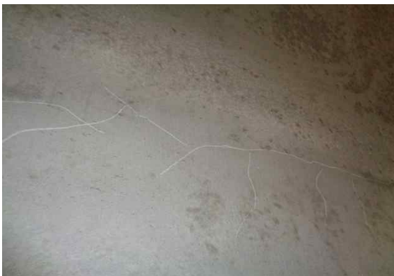
라이닝 SPAN.40 균열(0.3mm미만)
