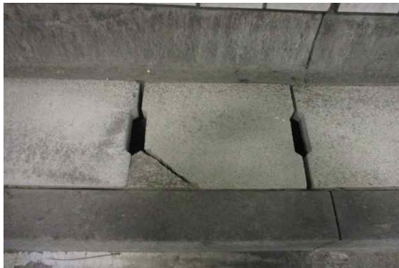
공동구 SPAN.22 덮개 파손
