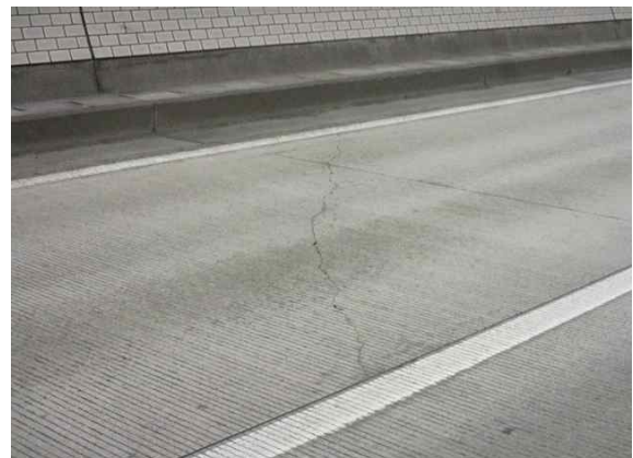
b. 포장부 SPAN.15 균열(0.3mm 이상)
