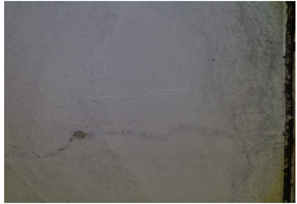
라이닝 SPAN.12 균열(0.3mm미만)
