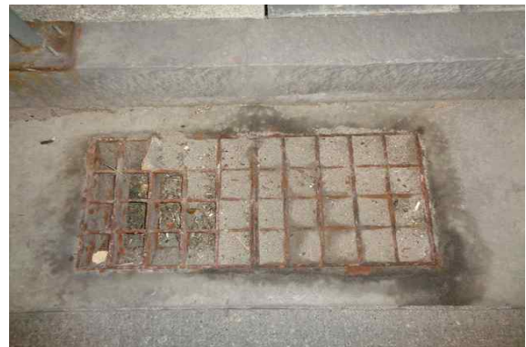
배수시설 SPAN.36 집수구 막힘
