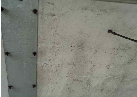
라이닝 SPAN.2 균열(0.3mm미만)
