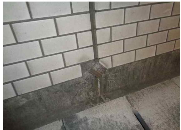
측벽부 SPAN.35 타일 탈락
