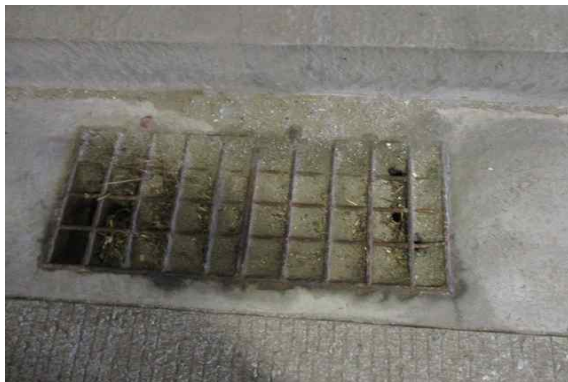
배수시설 SPAN.9 집수구 막힘
